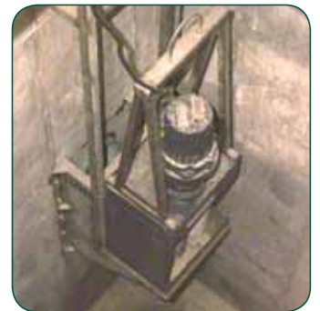
Channel Monster монтиран в помпена станция с подвижна рамка.
