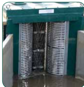
Модел CDD6020-XDM2.5 монтиран във входящия канал на ПСОВ.
